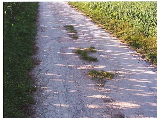
Tronçon détruit (chemin des Loës)
