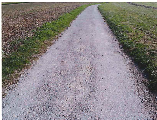
Tronçon dégradé (chemin des Grands Prés)
